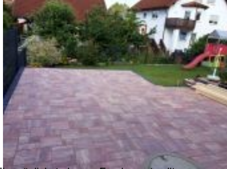
Ein möglichst ebenes Fundament sollte vorhanden sein, rundum können die Einzelteile nach Größe sortiert verteilt werden...
